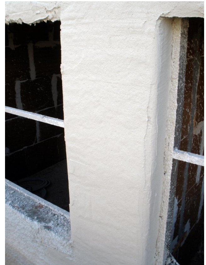
Rotura de puente térmico en ventana
